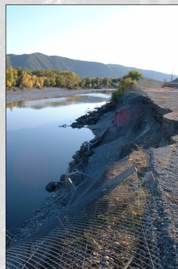
Exemple d'érosion de berge
