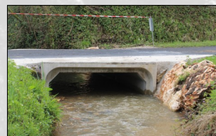
Dalot en béton
