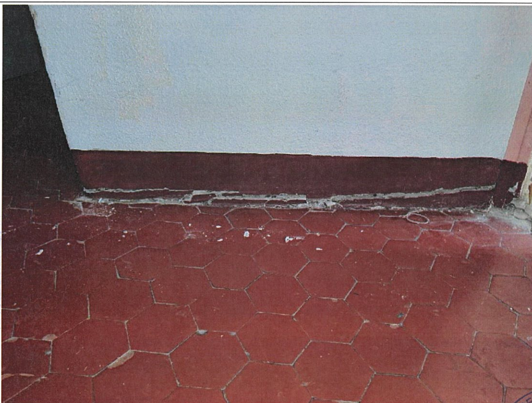
D- Vue d'une fissure dans le sas des chambres 5 et 6 situées au-dessus de la salle de restaurant.
